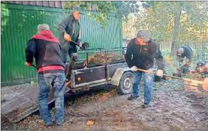
Die Männer packen kräftig an bei Erdarbeiten für Herbstpflanzungen Vereinsmitglied Gärtner Mittendorf hat sich um Vorbereitung dieser Maßnahme gekümmert.
